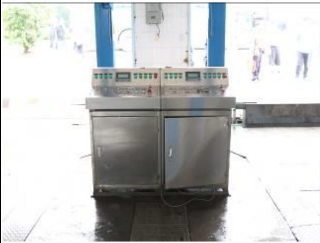
紹興市越城區垃圾中轉站機械操作儀器
