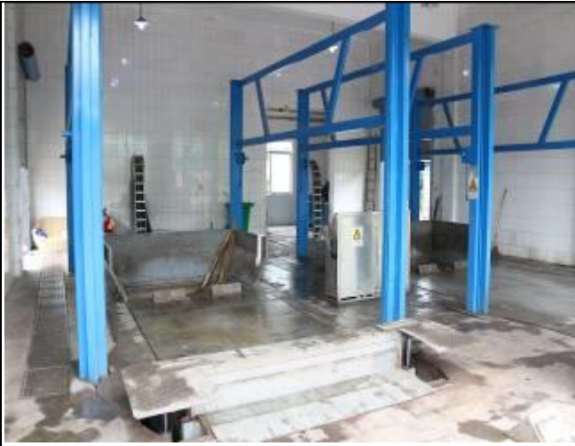
紹興市越城區垃圾中轉站將垃圾壓縮成塊狀後機械操作轉運至掩埋場
